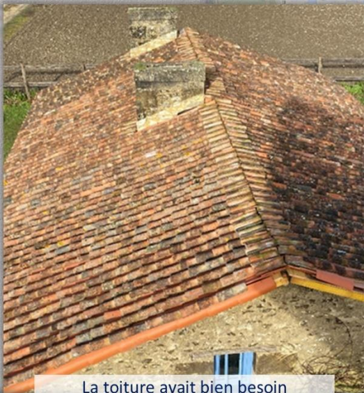
La toiture avait bien besoin d'une remise à neuf
